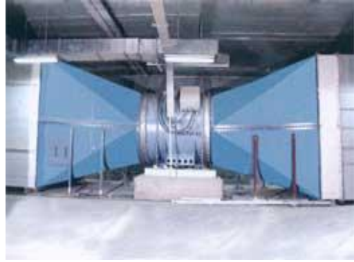
TUNNEL VENTILATION FAN
